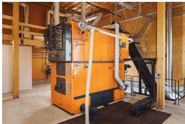
Anfang Dezember wurde der Heizkessel der Schweizer Firma Schmid erfolgreich in Betrieb genommen.
